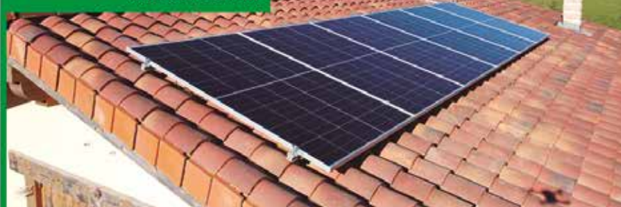
Autokontsumorako instalazio isolatua Olaztin
